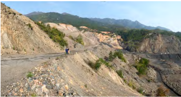
▲ 宁都县青塘镇废弃煤矿土壤及区域次生污染防治工程设计施工总承包项目
