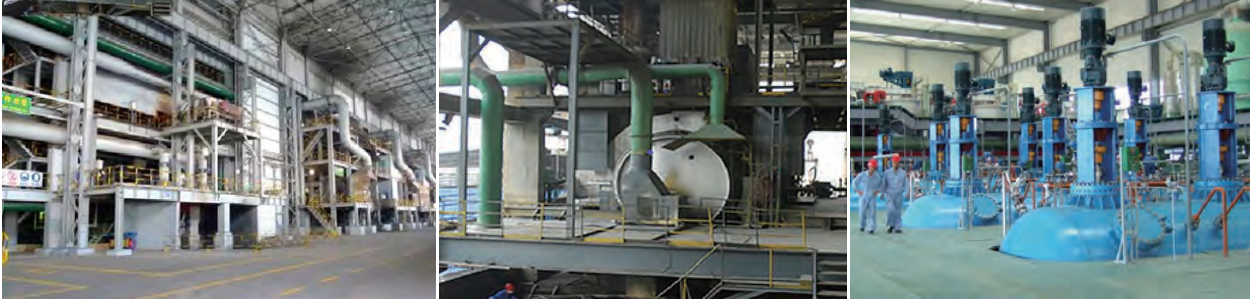
▲ 白银有色集团股份有限公司西北铅锌冶炼厂锌冶炼资源综合利用项目
