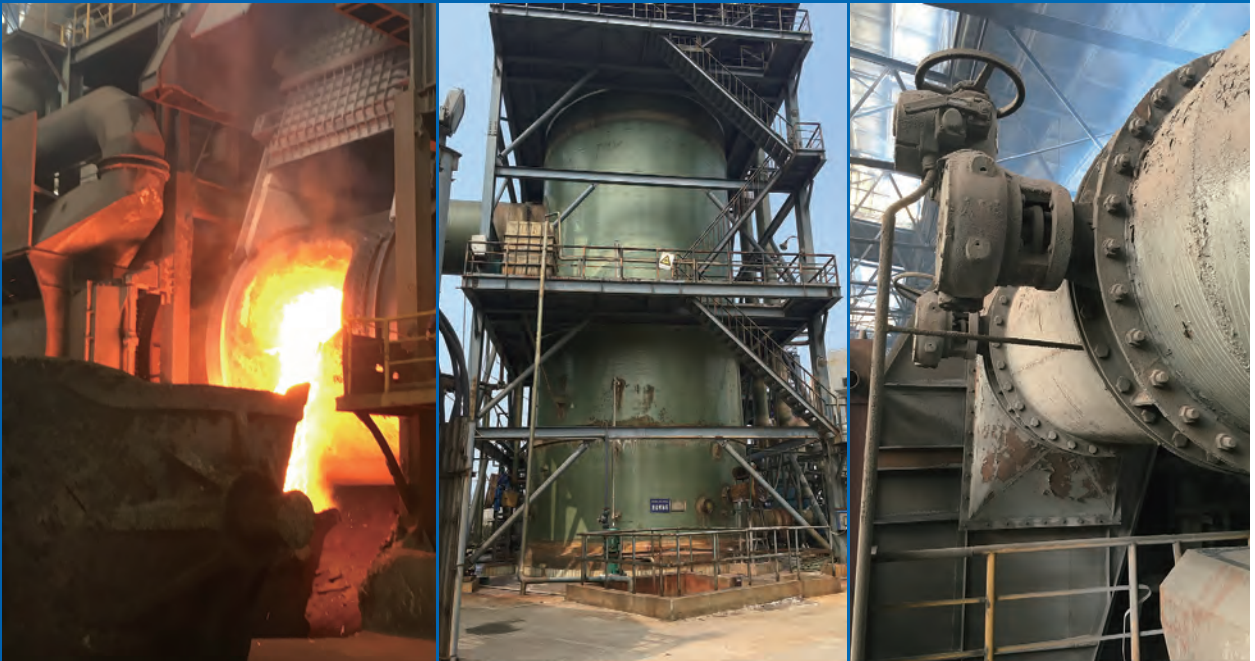
▲ 大冶有色金属股份有限公司铜冶炼节能减排改造项目
